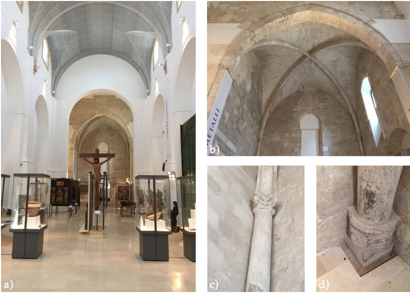
Fig. 6. Bari. Chiesa di San Francesco della Scarpa. a) Interno b) Abside c) Particolare del capitello d) Particolare della base (foto dell'autrice).
