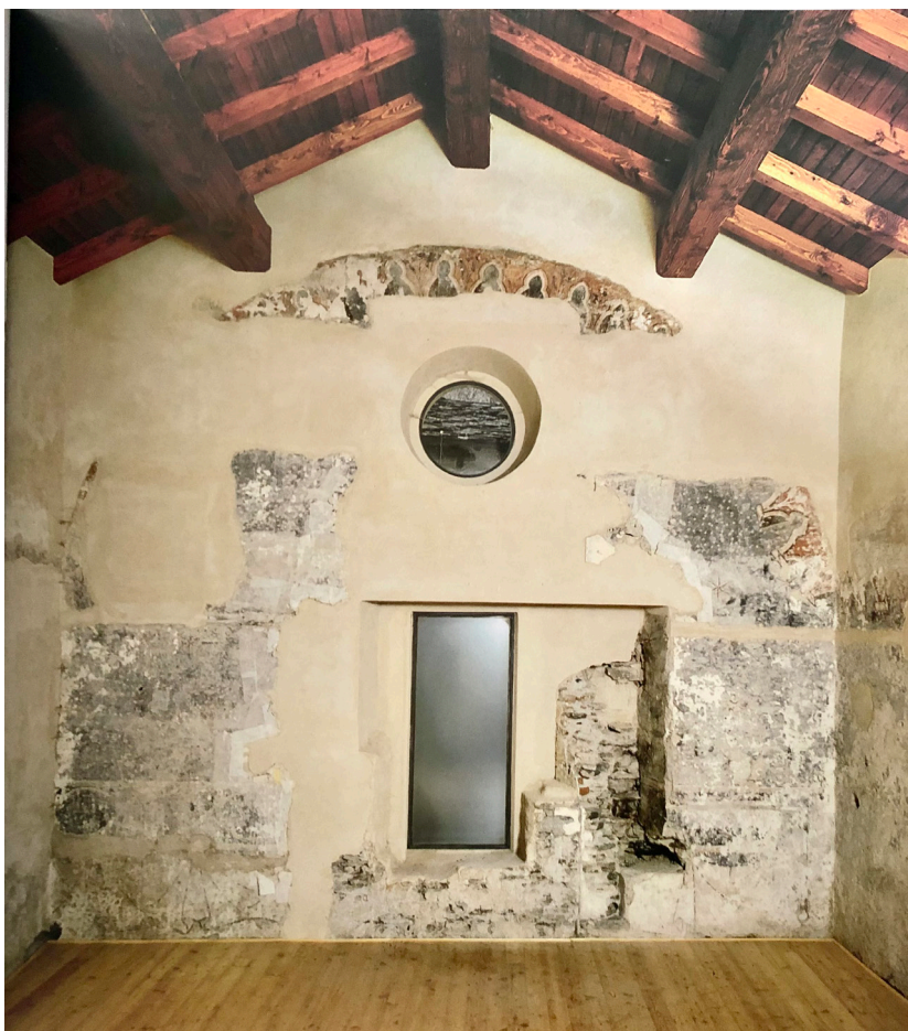
Fig. 6. Vista interna della Camera stellata, durante le opere di restauro pittorico (in CERRI 2004, p. 145).
