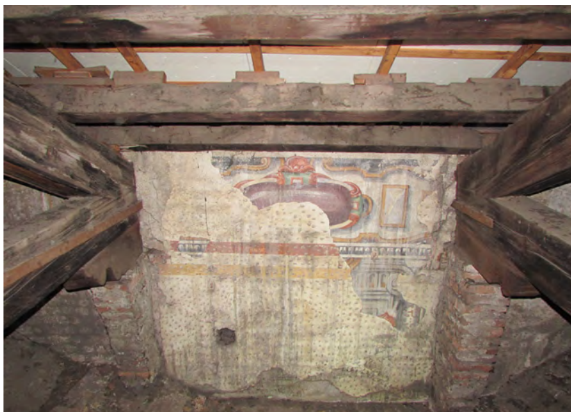
Fig. 5. Milano, San Marco. Sottotetto della navata centrale, lacerti di affreschi (foto dell'autrice).
