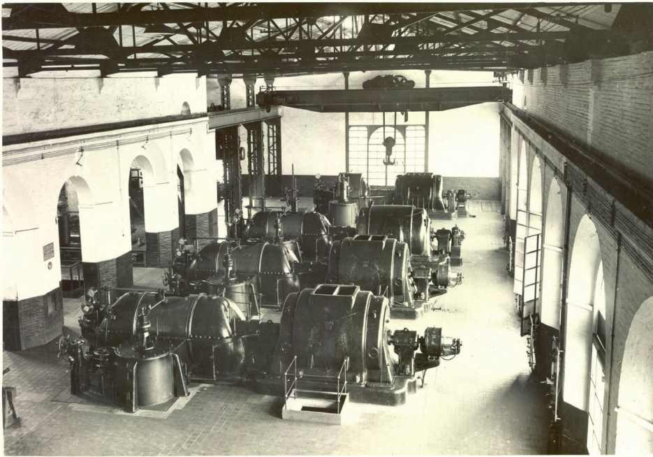
Fig. 4. Centrale di Larderello, sala macchine (Archivio Storico ENEL, Napoli).
