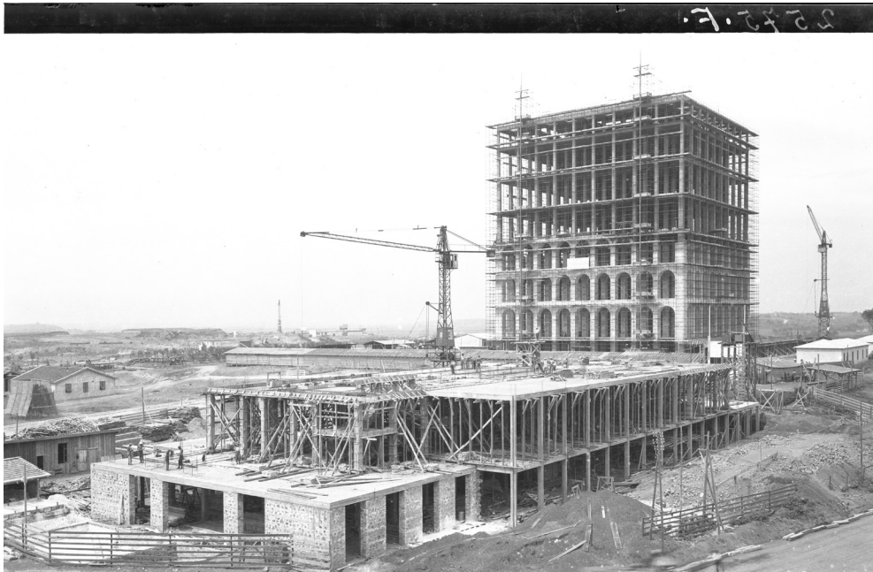
Fig. 1. Il Palazzo della Civiltà Italiana e l'edificio del ristorante in costruzione (28/07/1939). ACS, Ente Autonomo Esposizione Universale di Roma, Sezione fotocinematografica, Negativi, n. 2575F.
